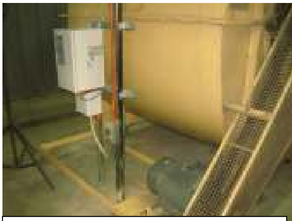
Rm 7.01–DICER 1–VSD Main Return Air Fan
